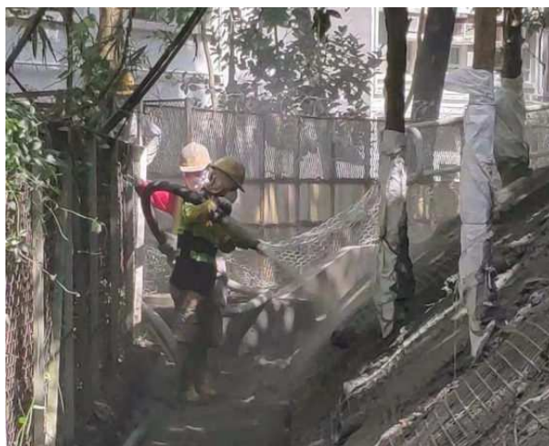
工人身後鐵絲網的另一面即為該行人通道
